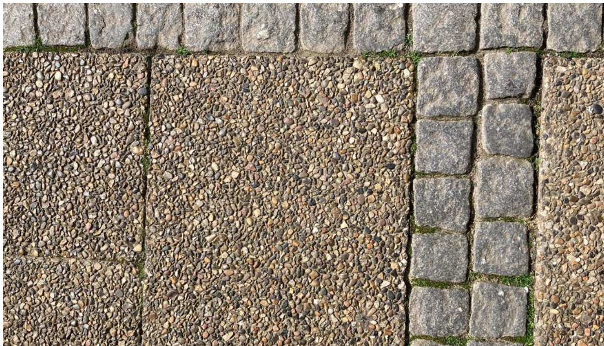
Betonflise med blotlagte søsten, 2024.
